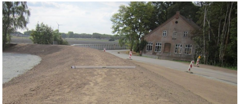
Neu profilierter Deich mit Kleidecke und Treibselräumweg (links) im Werderland nahe der Moorlosen Kirche
